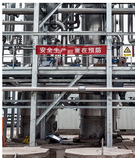
Cambi THP plant. Chongqing, China.
